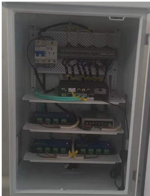
采集箱内设备接线情况
